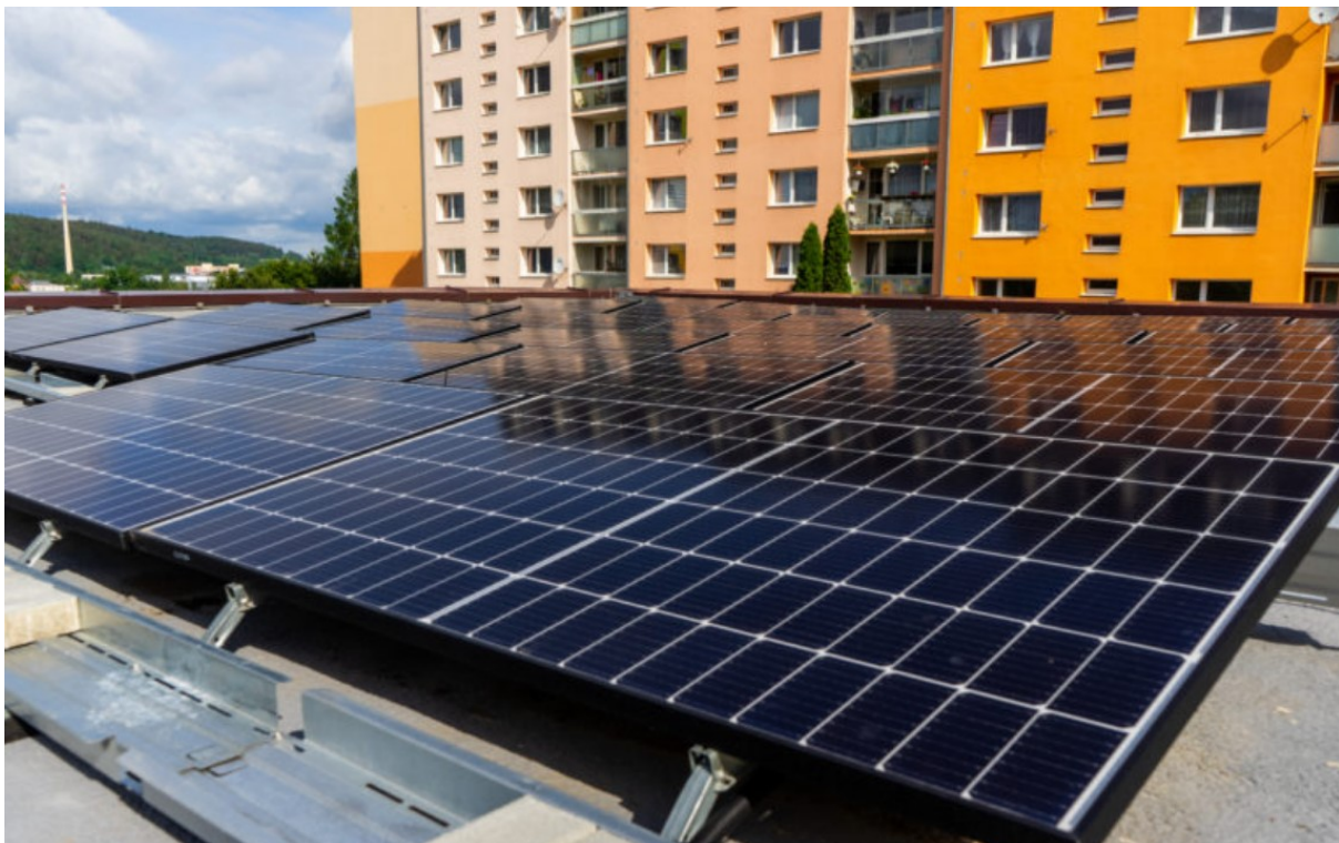
Fotovoltaická elektrárna 10 kWp na zdroji Z90 B-Němcové
