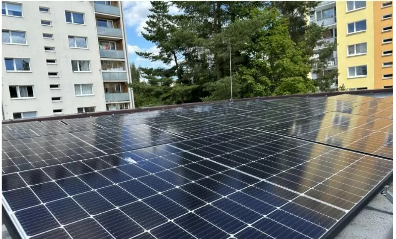
Fotovoltaická elektrárna na zdroji Z90 Božebý Němcové
