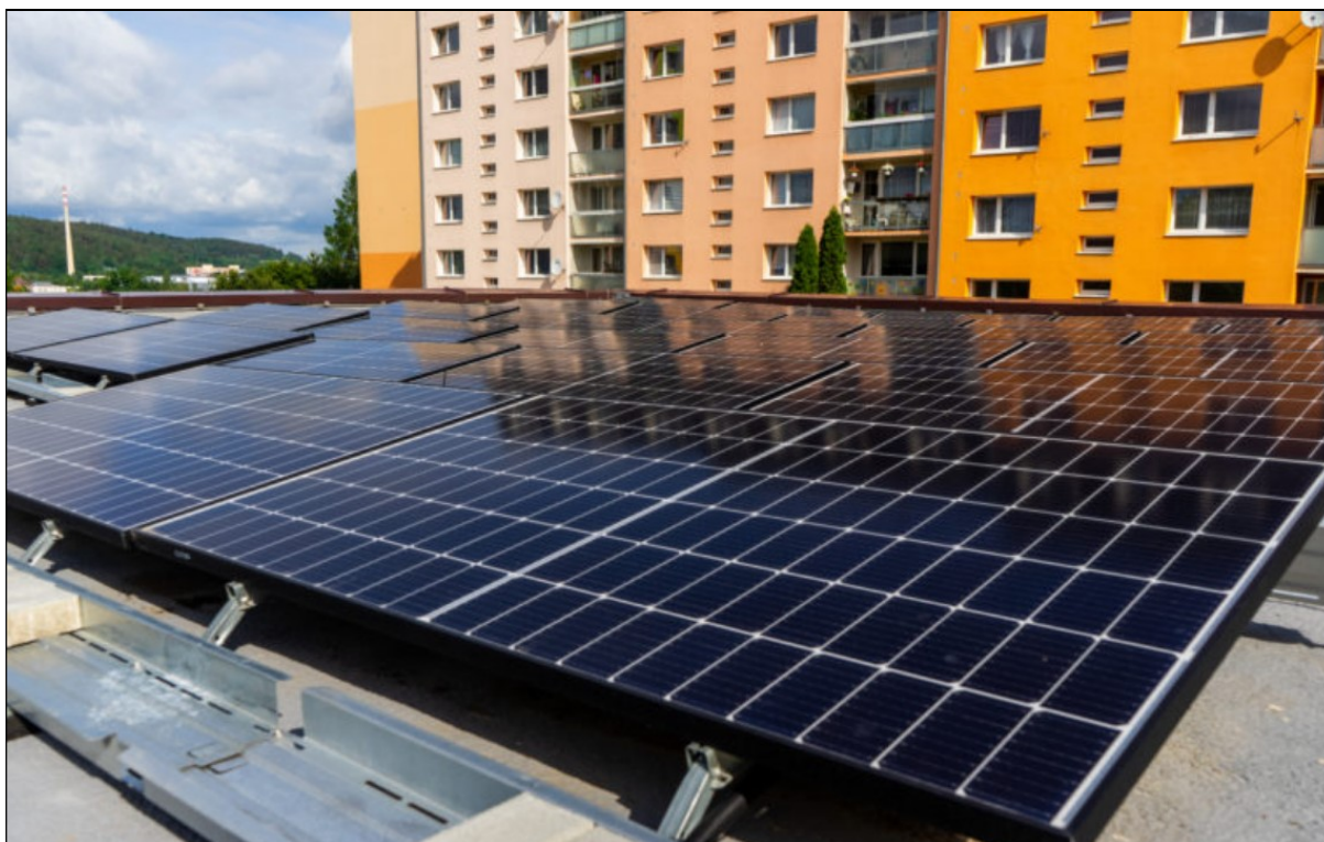
Fotovoltaická elektrárna 10 kWp na zdroji Z90 B-Němcové
